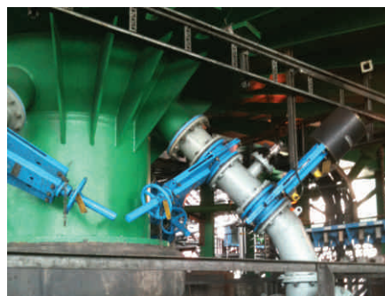
Установка для мокрого обогащения угля
